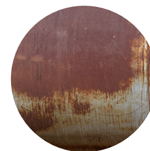
Konstrukce ocelové nádrže v průběhu času zkoroduje
