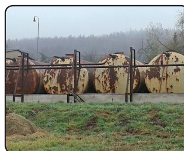
Nevyhovující uskladnění hnojiva DAM 390
